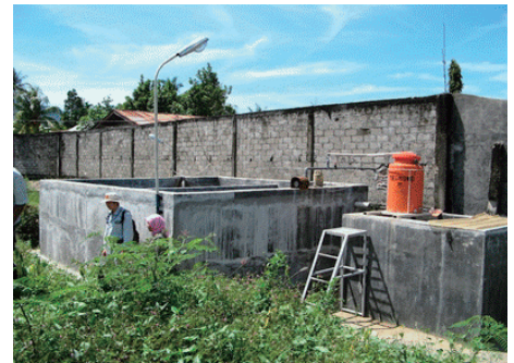
ヤシ油製油工場の実証排水処理装置
