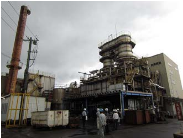
潮見工場焼却炉
