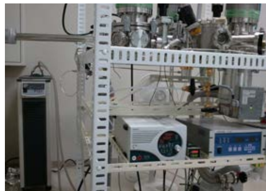
図2. 真空スパッタ堆積装置に使用された冷却水循環装置
