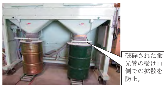
2. 廃棄蛍光管類の前処理機械の破砕物出口 ”破砕物収納ドラム缶”
