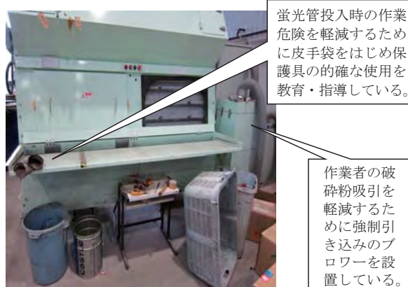
1. 廃棄蛍光管類の前処理機械の蛍光管投入口 ”蛍光管破砕機”
