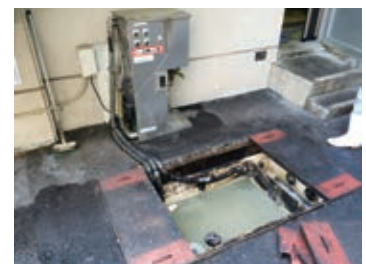
グリストラップの様子 (集約枘のフタを開けたところ)
