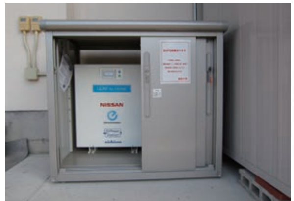
電気自動車接続ユニット
