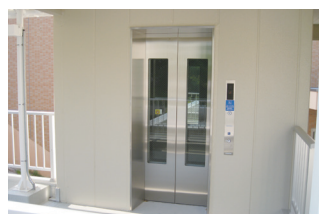
エレベーター 2階出入口
