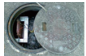
脱リン装置設置状況
