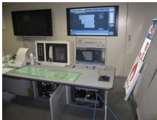
老朽化施設の改修整備が完了した防災監視システム
