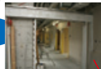
女性病棟部分は、廊下エリアが自動ドアで区分されICカードでの出入りとなります。写真は自動ドア設置箇所。
