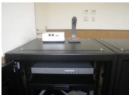
【中央監視設備(非常放送)】
