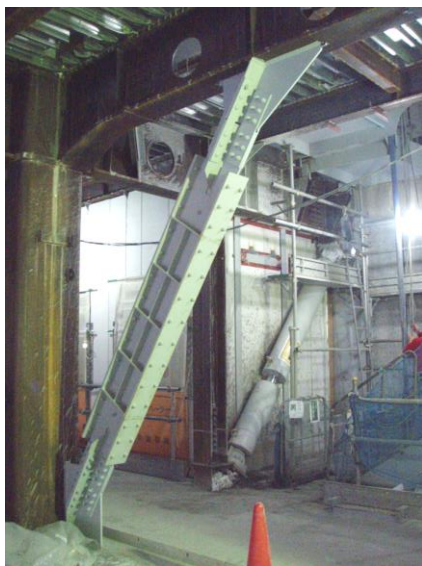
一般的なビルで採用されている制振ダンパーの例
