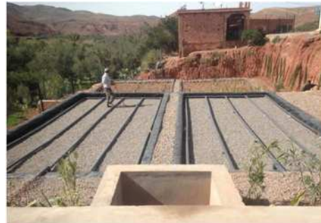
マラケシュ市郊外の村落排水処理装置
