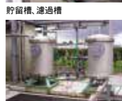
リン除去・回収槽
