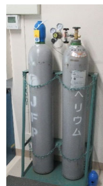
ガスボンベ ボンベ架台
