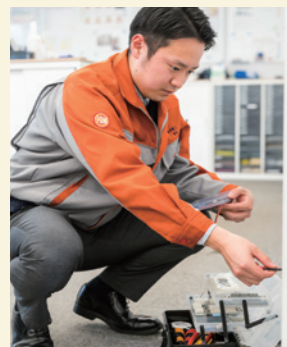
コンセントの調整をする鍛冶さん。入社後に第2種電気工事士、消防設備士の資格も取得しました。
