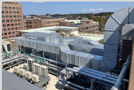
(動物実験施設屋上、改修した空調設備ダクト)
