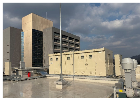
■ 屋上キュービクル（受変電設備）
