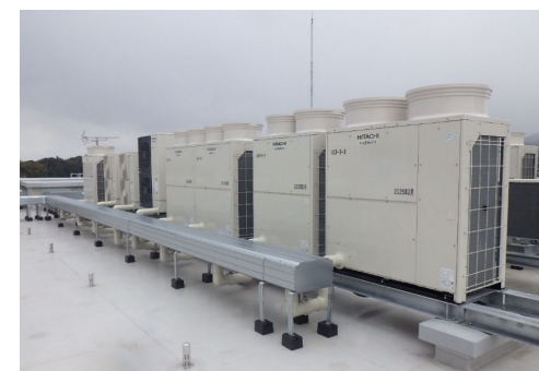
■ 屋上空調室外機
