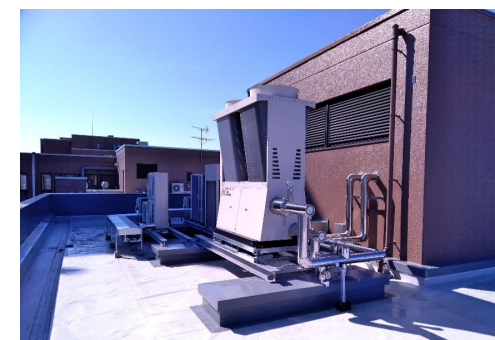
■ 2階BSL3用チラー（屋上室外機）
