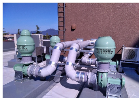
■ 屋上ドラフトチャンバー用排風機
