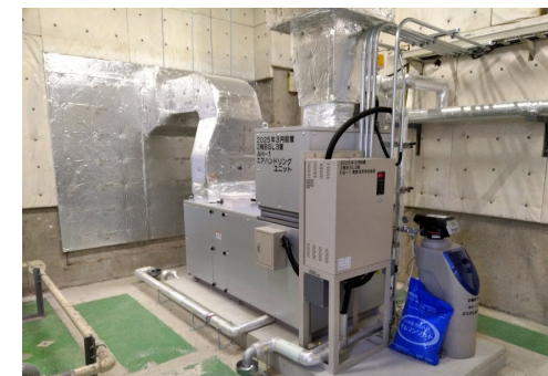
■ 2階BSL3用空調機（屋上機械室内）
