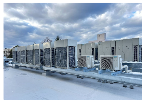
■ 屋上空調室外機
