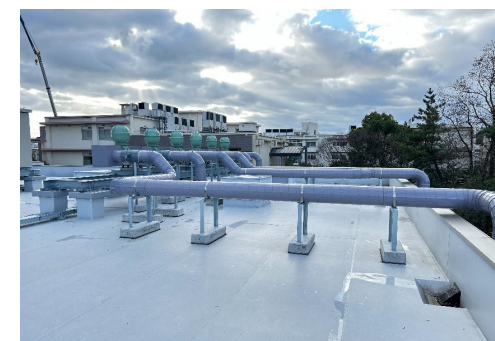
■ 屋上ドラフトチャンバー用排風機
