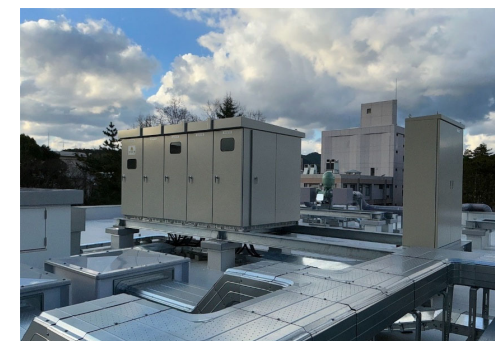
■ 屋上キュービクル（受変電設備）
