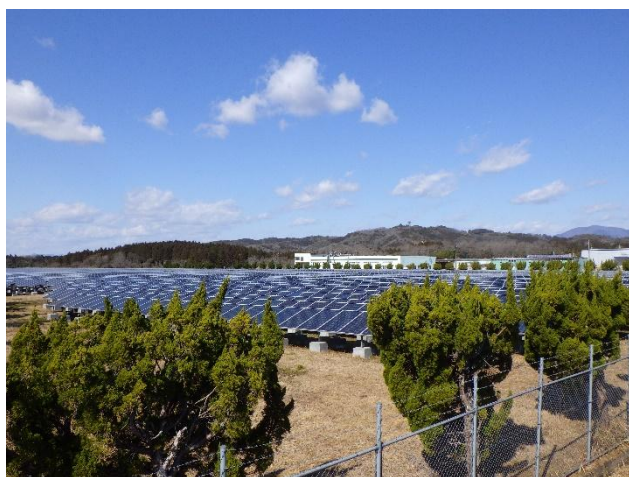
岡山県津山市に設置されたメガソーラー
